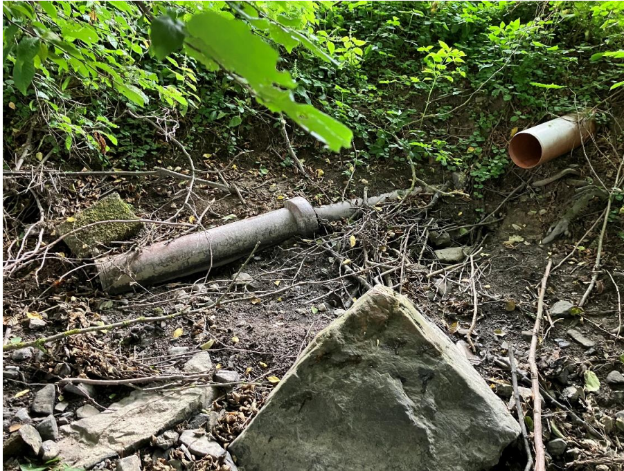
Abb. 5: Abflussrohre am Bachufer unterhalb der Pferdeställe des Tannenhofs, 24.07.2025
