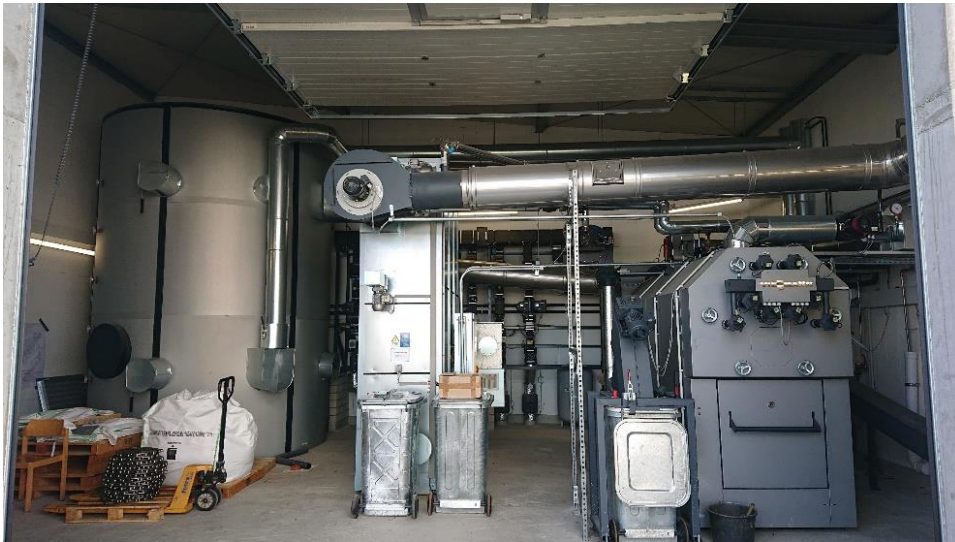
Abb. 7: Technik der Heizzentrale - Biomasse-Kessel und Pufferspeicher (Foto Stadt Neu-Anspach)
