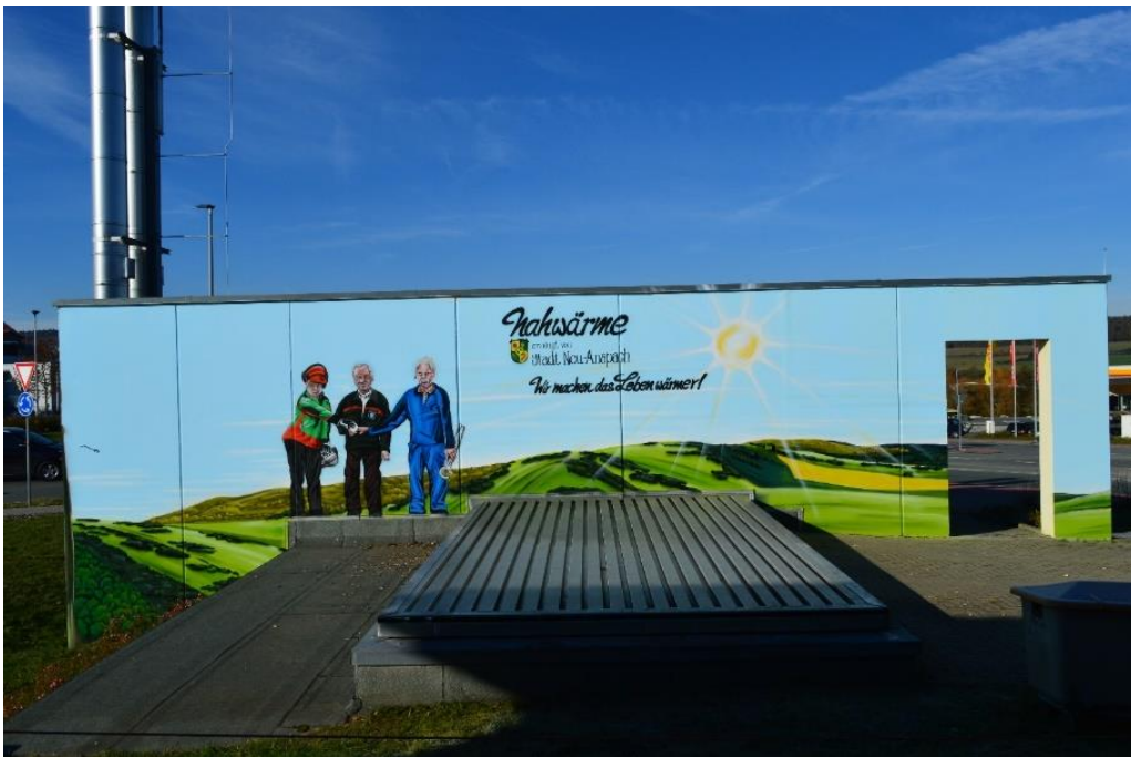
Abb. 3: Holzhackschnitzel-Heizanlage mit Hackschnitzel-Bunker (Foto Stadt Neu-Anspach)
